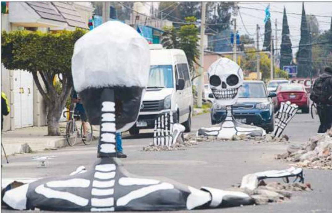
▲ El mal estado de la carpeta asfáltica en la calle Francisco Santiago Borra fue aprovechado por Raymundo Medina para montar dos enormes calacas de cartón en los hoyos. Buscó dos cosas, expuso: llamar la atención de las autoridades para que los reparen y recordar
