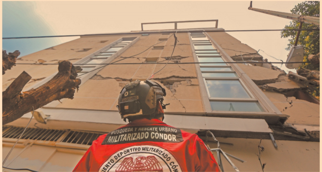
Estructuras. Edificios, sobre todo en Oaxaca y la capital del país, se dañaron y algunos fueron desalojados. FOTO EE: ERIC LUGO
