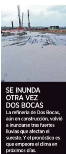
SE INUNDA OTRA VEZ DOS BOCAS La refinería de Dos Bocas, aún en construcción, volvió a inundarse tras fuertes lluvias que afectan el sureste. Y el pronóstico es que empeore el clima en próximos días.
