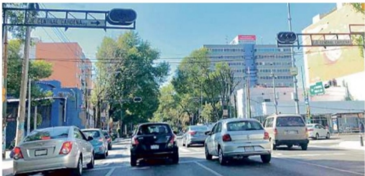
Cientos de semáforos en la CDMX, como en el Eje 5 Sur, quedaron fuera de servicio.
