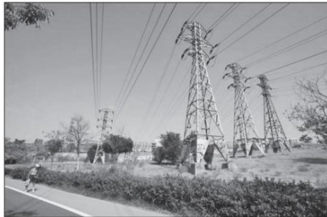
Subestación eléctrica en Madrid, España, donde los precios de la electricidad han alcanzado récords ■ FOTO: LA JORNADA
