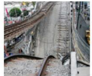
Estaban mal soldados.
