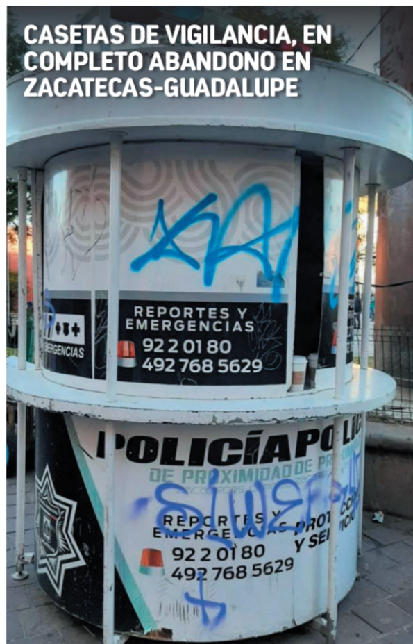
Las casetas de vigilancia policiaca se encuentran vandalizadas y en malas condiciones, por lo que organizaciones civiles lanzaron una campaña de rehabilitación para mejorar los espacios públicos. Cortesía
