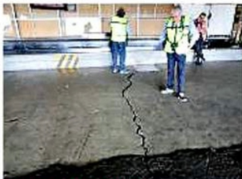
¡AHORA SÍ SE PREOCUPAN? Desde marzo de 2019, el nuevo Gobierno de AMLO sabía los serios problemas de hundimientos y daños estructurales de la Terminal 2. PÁGINA 6
