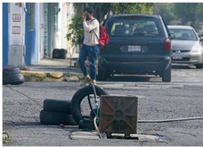
En la red hidráulica se han detectado tomas clandestinas en las que se instalan mangueras y bombas para llevar el agua a puntos de almacenaje.
