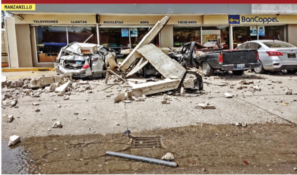
Parte de la fachada de una tienda departamental en Manzanillo, Colima, se desprendió y cayó encima de un hombre, el cual falleció. Foto: Especial
