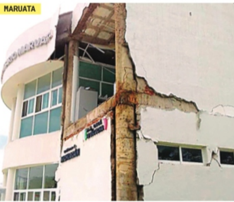
El sismo dejó daños en 21 centros de atención médica en Michoacán, entre ellos el Hospital Integral de Maruata. Foto: Especial
