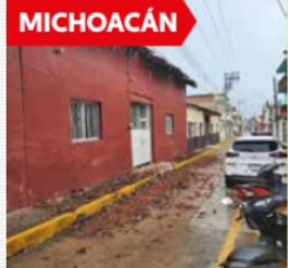
COALCOMÁN. Reportaron daños en varios edificios, hospitales y templos.
