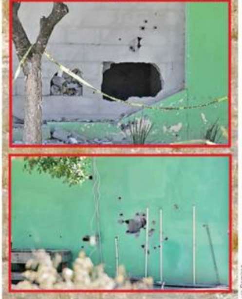
Vestigios del enfrentamiento del 2 de enero en Salinas Victoria, entre un cártel y policías, están a la vista en el rancho El Palmar, donde unidades blindadas estatales destruyeron paredes (1 y 2) y muros quedaron baleados.
