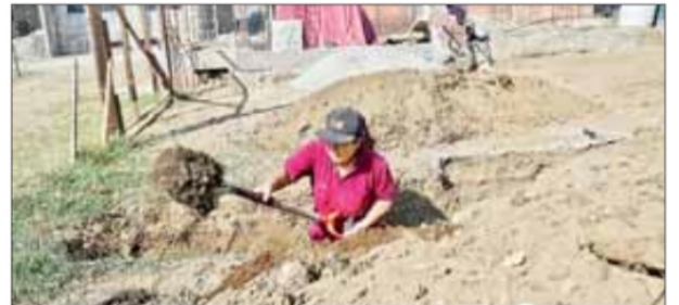
▲ Cargar tabiques o bultos de cemento no fue obstáculo para que María Santos desempeñe un oficio que ama: la albañilería. Foto Luis Castillo
