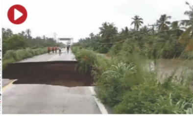
COLAPSO de la carretera Acapulco-Zihuatanejo, ayer.
