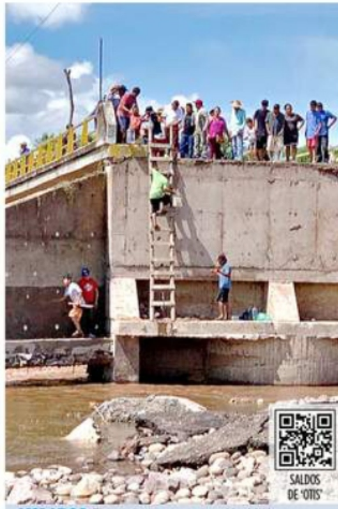
AISLADOS. El puente que conecta a Ajuchitlán con San Miguel Totolapan, en Guerrero, se derrumbó y dejó aisladas a varias comunidades.
