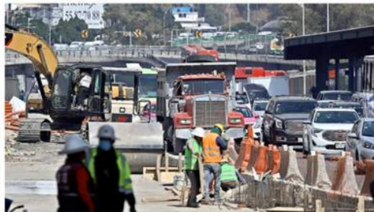
Las obras en Indios Verdes, que ya llevan tres años, han generado caos vial y contaminación.
