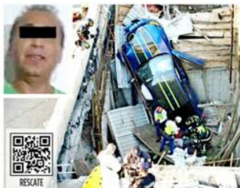
El auto BMW en el que viajaba la víctima cayó en una zona de excavación cerca de la Plaza Artz.
