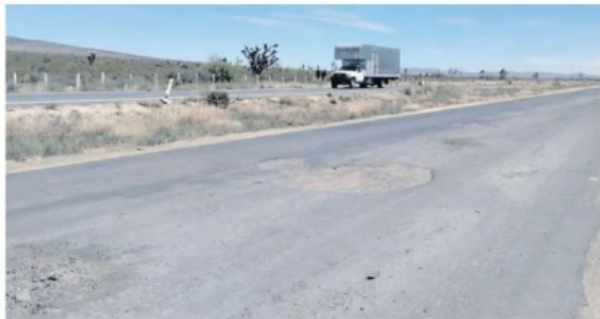
EN PÉSIMAS condiciones, vía hacia Saltillo, Coahuila.
