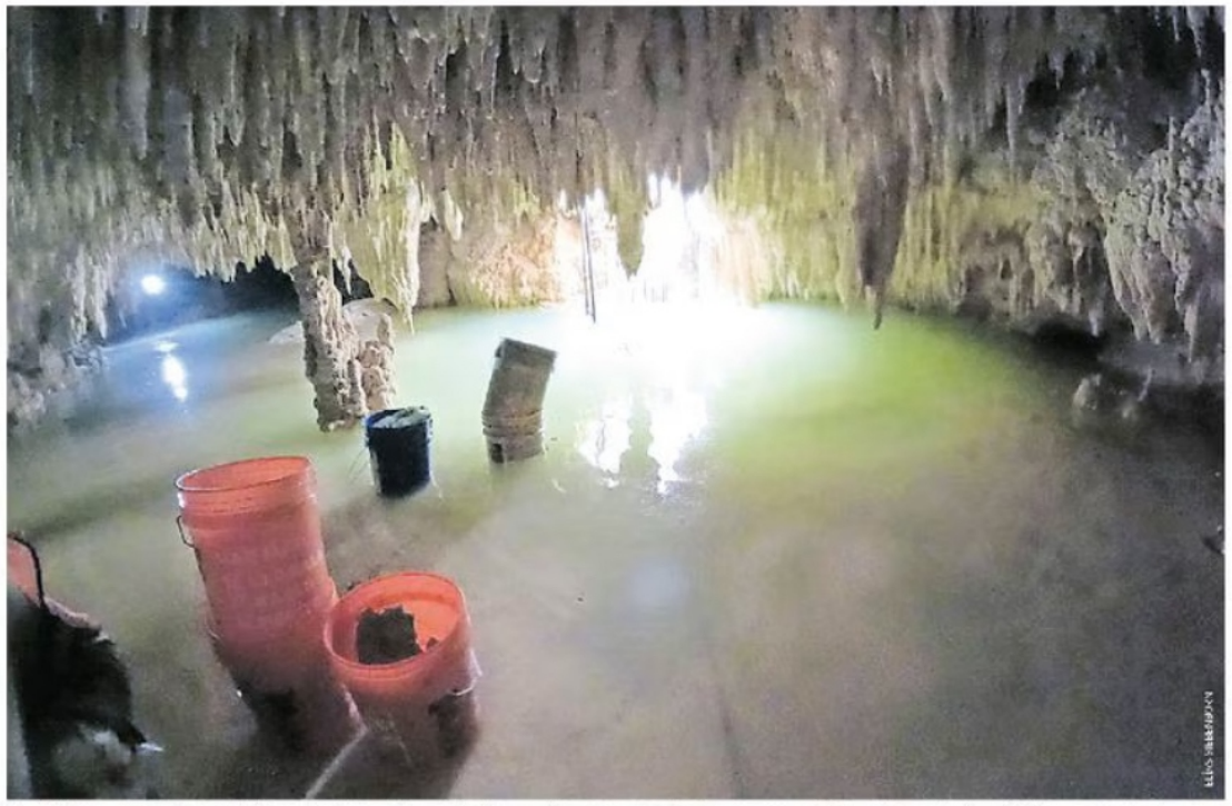
En el informe se detalla que al colocar los pilotes hubo afectaciones en las cavernas sobre las que corre el Tramo 5 Sur, como la caída de cemento en el agua.
