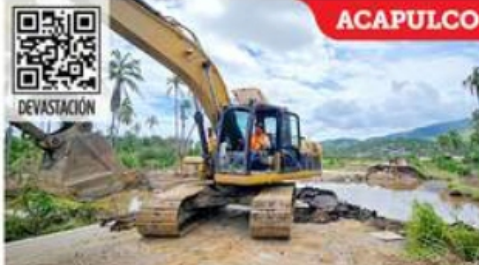
La carretera que comunica a Coyuca de Benítez con la Costa Grande, se encuentra dañada.
