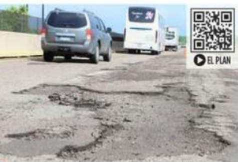
Las obras del Tren Maya dejaron casi mil kilómetros de carreteras dañadas, según datos de la SICT.
