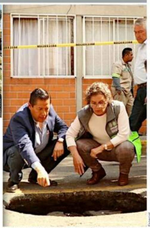
La Secretaria de Gestión Integral de Riesgos y Protección Civil de la CDMX, Myriam Urzúa, acudió ayer al socavón. Militares resguardaron los trabajos en la zona.
