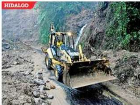
Varias carreteras, como la Tulancingo-Tenango, quedaron bloqueadas por lodo, rocas y árboles caídos.
