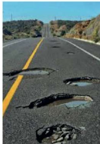
Carretera con baches
