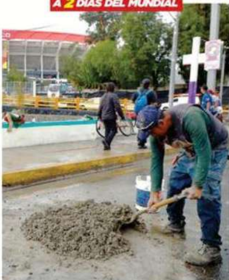
A marchas forzadas y entre la lluvia, continúan las obras afuera del Estadio mundialista en la CDMX.
