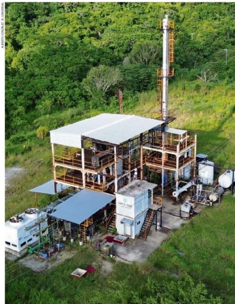
La minirrefinería asegurada en 2025 en Coatzacoalcos actualmente se ve abandonada y sin ser desmantelada.
